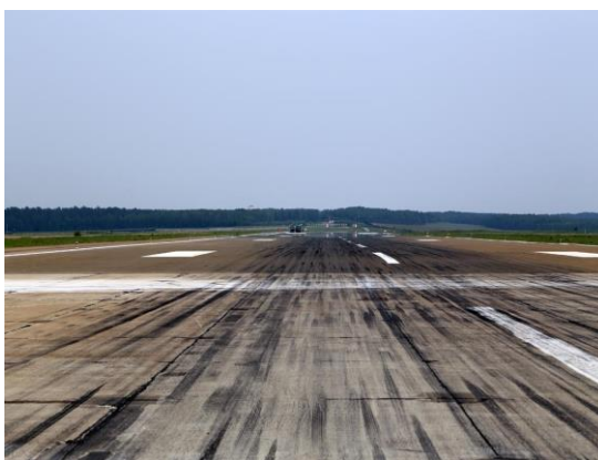
Рис. 1. Иркутск (аэропорт), состояние ВПП на 2020.
